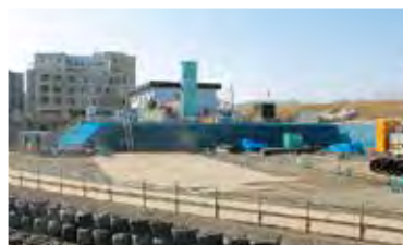
ポンプ増設工事が進む 久留米市下弓削川枝光排水機場
